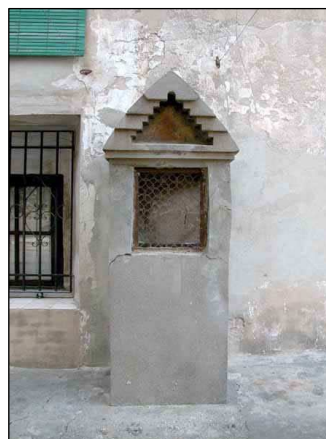
Chimenea de ventilación externa
