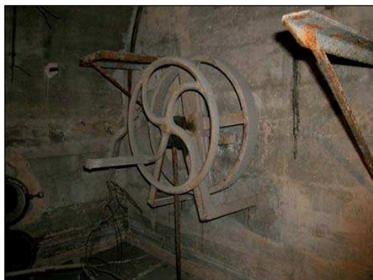
Apertura interior del sistema de ventilación
